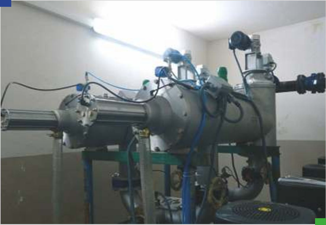
Eğlence 2 Hidroelektrik Santrali (Adana)
