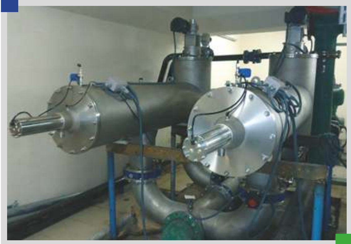
Eğlence 1 Hidroelektrik Santrali (Adana)
