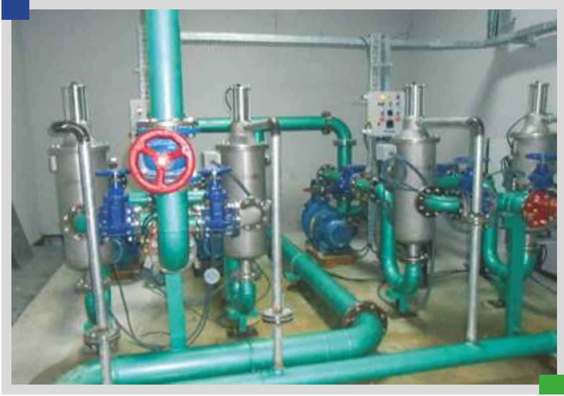
Kalecik 3 Hidroelektrik Santrali (Ankara)
