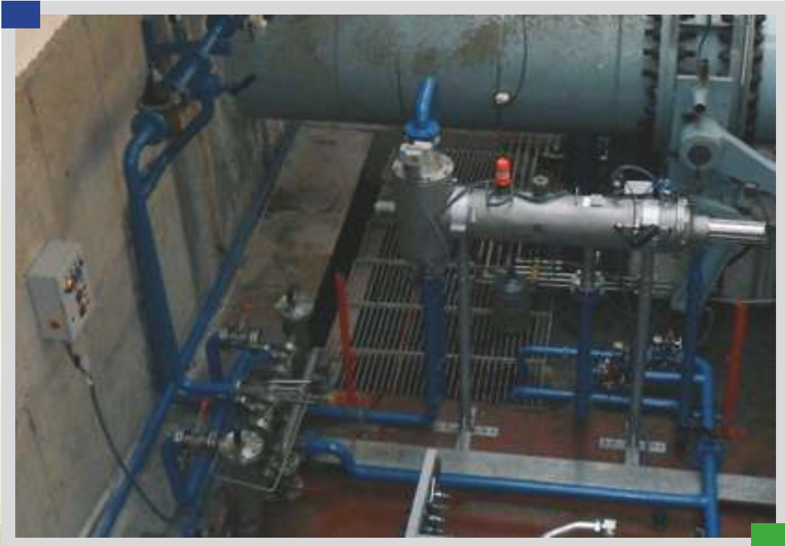
Paşa Hidroelektrik Santrali (Bolu, Mengen)
